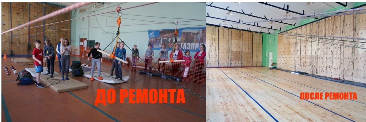
Рисунок 1 – Зал для занятий спортивным туризмом МАУ ДО «Станция детского, юношеского туризма и экологии» до и после ремонта
